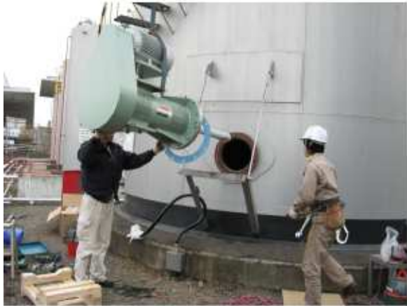
図5 : 側面型攪拌機の取り付け ASP 型
